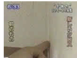
未工事のクロスが...
